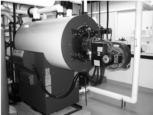
Caldera de fuel
