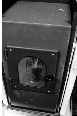
Caldera a gas para calefacción
