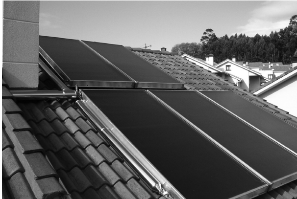
Paneles solares de una instalación solar térmica doméstica
