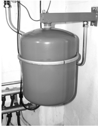
Ejemplo de sistema de acumulación: termo eléctrico
