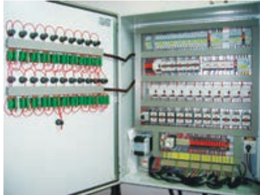
Cuadro eléctrico de distribución
