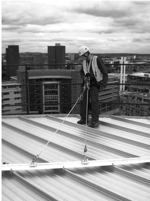
Trabajar en cubiertas es un factor de riesgo que puede dar lugar a caídas a distinto nivel.
