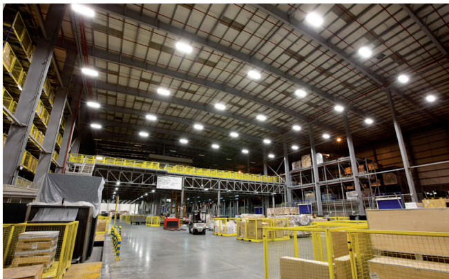
Lugar cerrado iluminado con un sistema de iluminación artificial general
