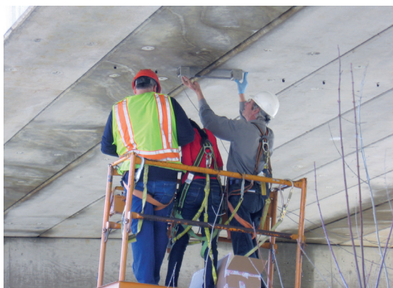
Plataforma de trabajo con su barandilla
