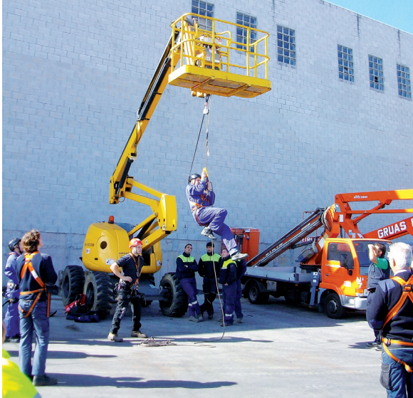
Uso incorrecto de una plataforma elevadora: la formación en PRL es esencial para evitar accidentes.
