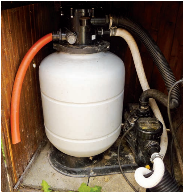
Kit de filtración formado por soplado con válvula selectora y bomba de piscina (© Fotografía: Pavel Ševela, vía web-CC BY-SA 3.0)
