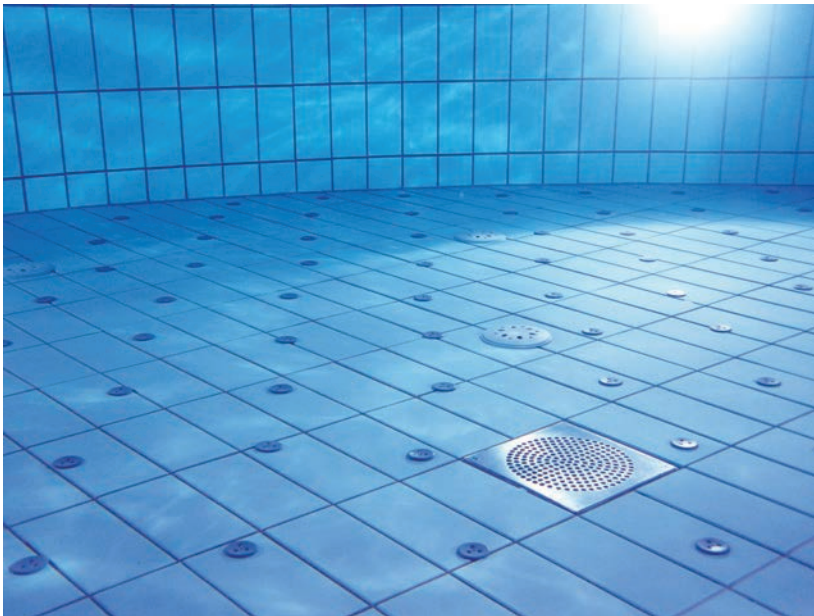
Desagüe de fondo de una piscina
