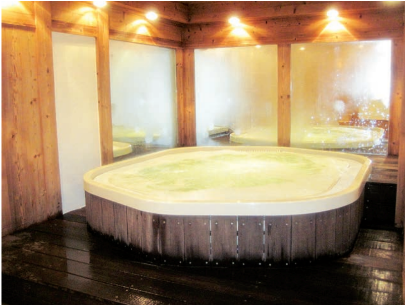
La piscina de hidromasaje se encuentra dentro de las instalaciones con mayor probabilidad de proliferación y dispersión de legionela.
