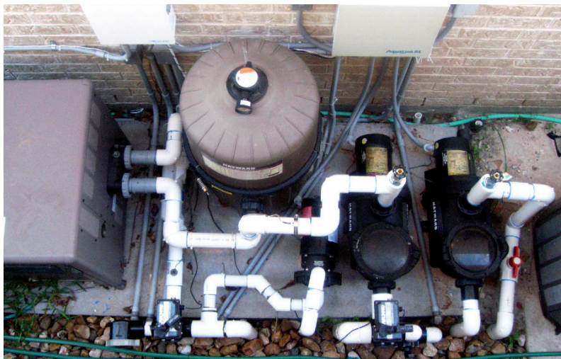
El mantenimiento de las instalaciones es esencial para evitar la aparición de la legionelosis (© Fotografía: billjacobs1, via web-CC BY 2.5)
