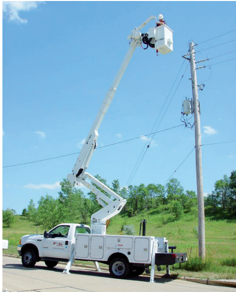
Trabajar cerca de líneas eléctricas puede dar lugar a descargas.
