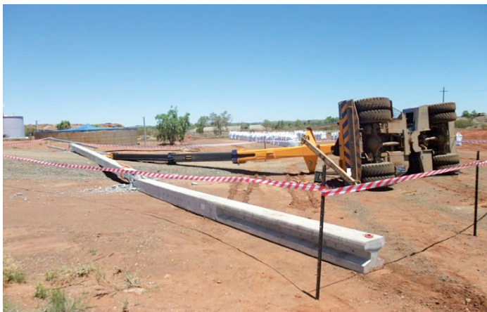
Accidente por el vuelco de una plataforma elevadora: si hubiese heridos habría que poner en marcha los primeros auxilios
