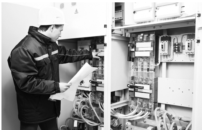
Instalación eléctrica en una empresa
