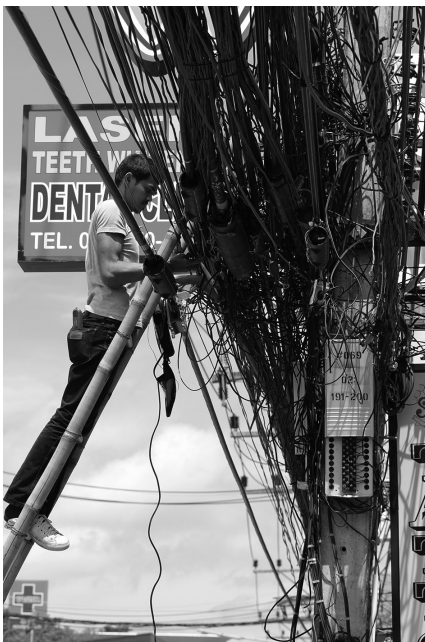
Riesgo eléctrico grave
