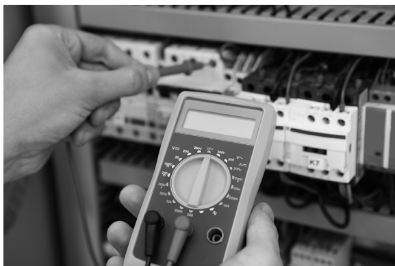
En esta imagen puede verse una prueba de aislamiento eléctrico, la cual puede realizarse con tensión.
