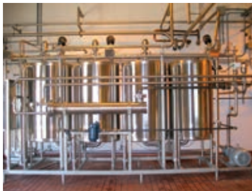
Central de limpieza CIP-SIP
