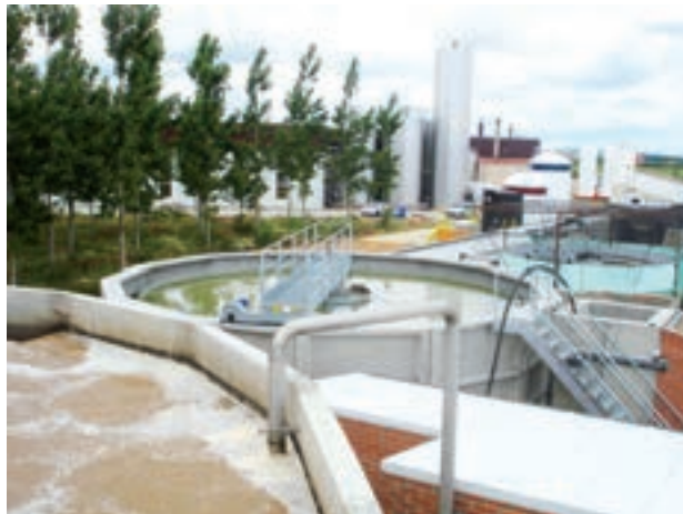
Instalación para la depuración de aguas en una industria láctea
