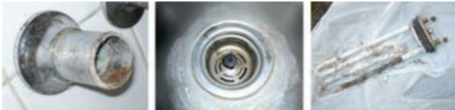
Corrosión originada por el agua
