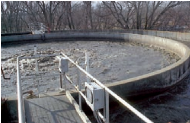
Estación depuradora de aguas residuales en una industria alimentaria
