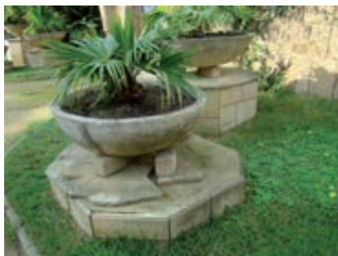
En este caso sería necesaria la reposición de piezas destruidas y desaparecidas
