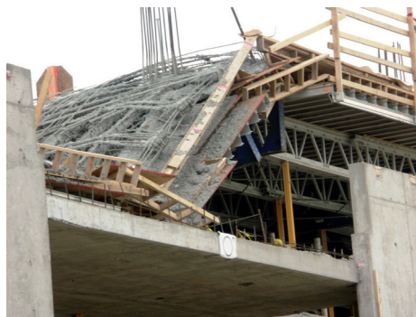
Consecuencias del derrumbe de un edificio de forma inesperada
